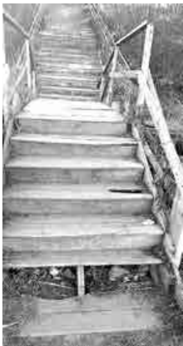
Зимой лестницу засыпает снегом, летом - мусором, а самое тревожное - никто ее не ремонтирует и она разрушается. Фото Галины ЭРХЕЕВОЙ.
